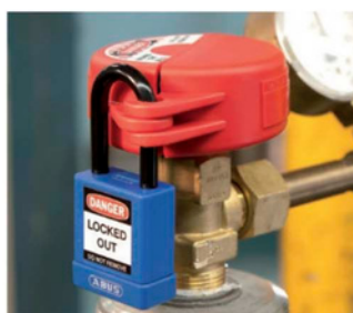
BLOQUEO DE VÁLVULA DE COMPUERTA
